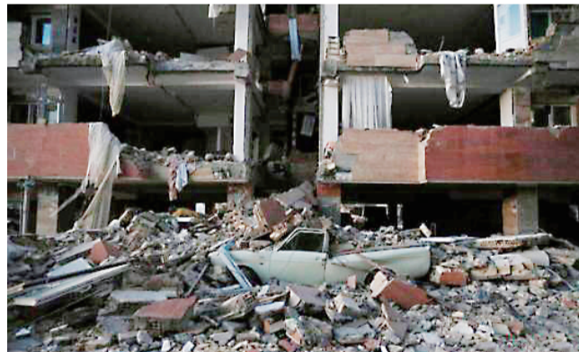
地震致两伊地区房屋损毁严重
